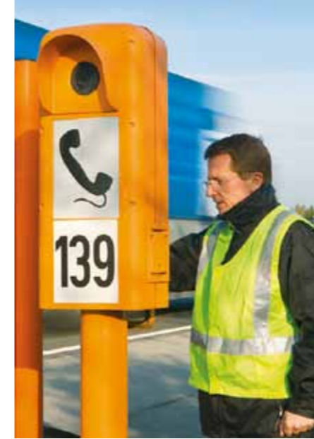
Acil durum çağrı sistemimiz, arayanı doğrudan kontrol merkezine bağlar ve trafik gözlem sistemleri tarafından izlenebilir.
